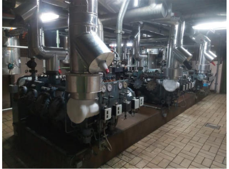
De bestaande emersol compressoren.
